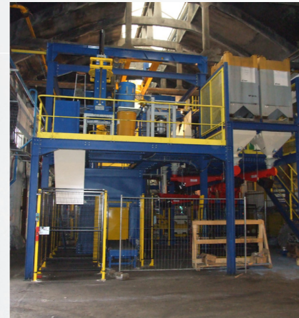
Installation de manutention de pulvérulent avec dosage et pesage.
